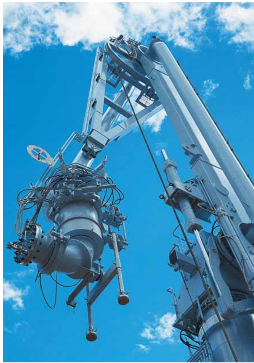
LNGを荷受けするローディングアーム
